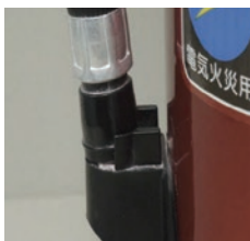
× 消火薬剤の漏れ
