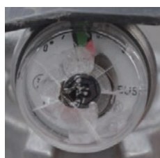
× 指示圧力計の損傷
