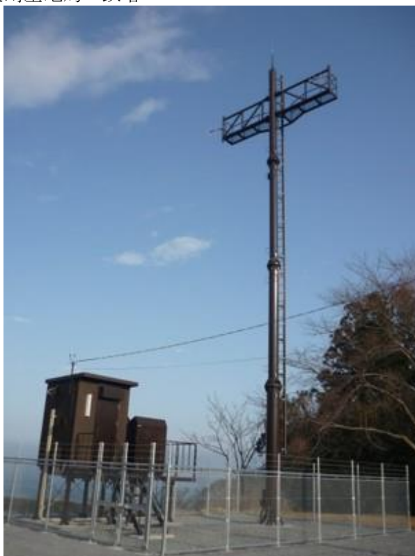
エ 長崎基地局・鉄塔
