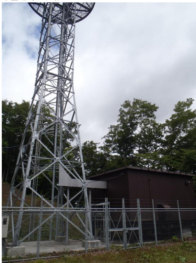
ウ 大平基地局・鉄塔
